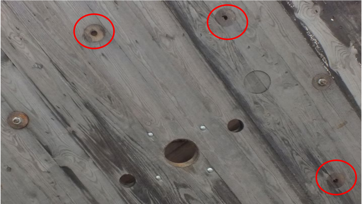
KUVA 5, MO = METALLIOSIA PUUTTUU
