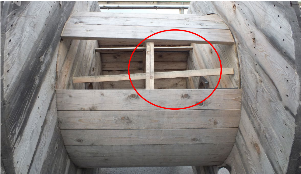
KUVA 4, RR = RUMPUVIKA; RUMPULAUTOJA PUUTTUU JA TUKIRAKENNE ON VIOITTUNUT
