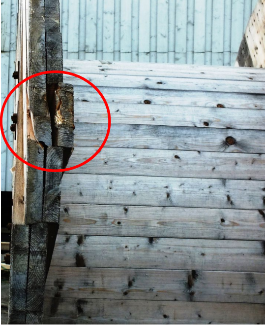
KUVA 3, LV = LAIPPA ON VÄÄNTYNYT (ESIM. KELA ON PUDOTETTU MAAHAN AJONEUVOSTA)
