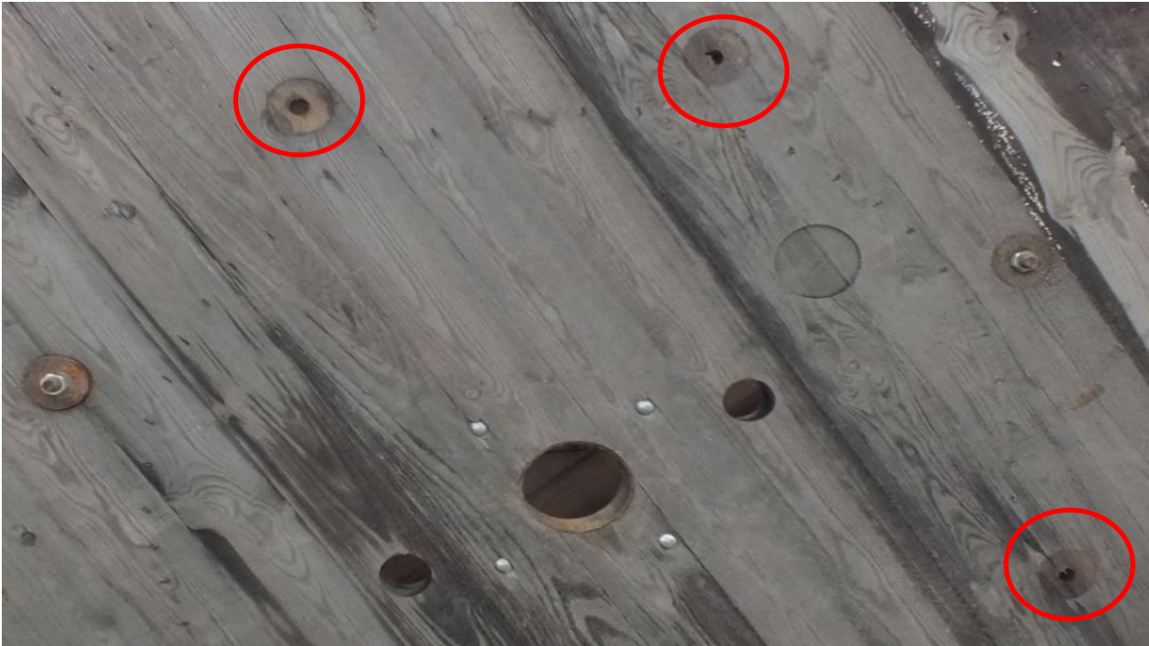
KUVA 5, MO = METALLIOSIA PUUTTUU
