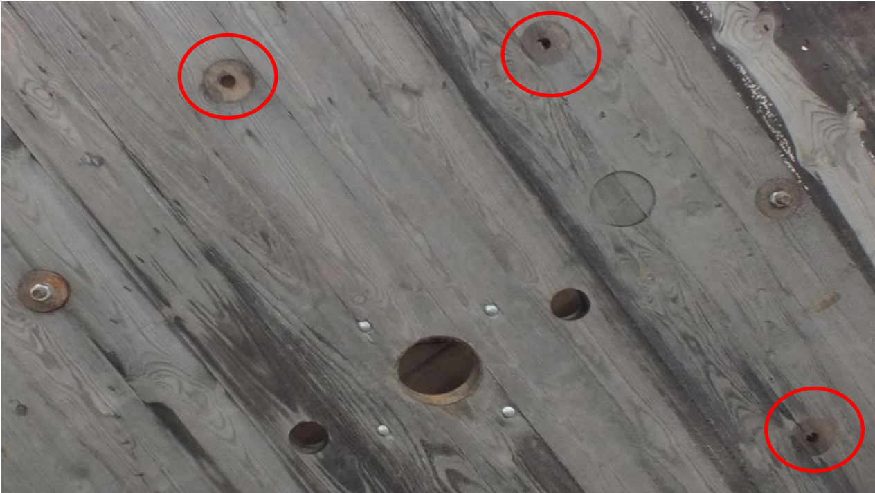
KUVA 5, MO = METALLIOSIA PUUTTUU
